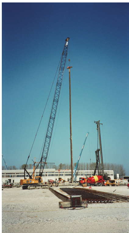
Figure 6-15 . Pose de la cage d'armature d'un pieu énergétique de 34 mètres de long sur le chantier Aldi à Domdidier (photo J. Wilhelm, 2007).
