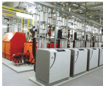
Figure 6-14. Pompes à chaleur et chaudières d'appoint
