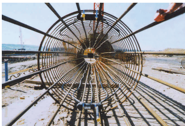
Figure 6-4. Conduites de circulation de fluide caloporteur fixées à la cage d'armature d'un pieu moulé (photo F-D. Vuataz, CREGE).
