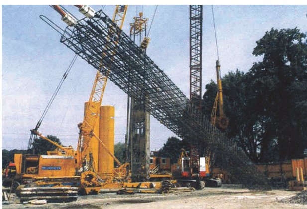
Figure 6-5 . Mise en place de la cage d'armature d'une paroi moulée équipée de conduites de circulation de fluide caloporteur (photo Nägelebau, Röthis).
