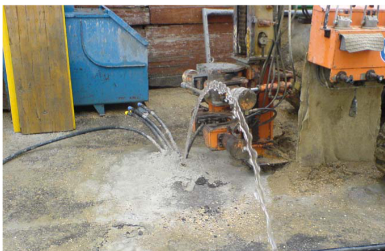
Figure 3: Venue d'eau souterraine sous pression - ou artésienne - le long d'un forage pour sondes géothermiques verticales, Val-de-Travers 2006.
