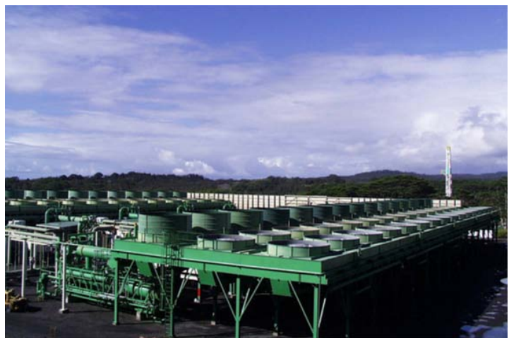
Figure 5.3.2 : Centrale géothermique ORC : exemple de Puna (30 MW e ), Hawaii, USA (Geothermal Education Office, USA).
