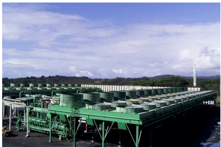
Figure 4.3.2 : Centrale géothermique ORC : exemple de Puna (30 MWe), Hawaii, USA (Geothermal Education Office, USA).
